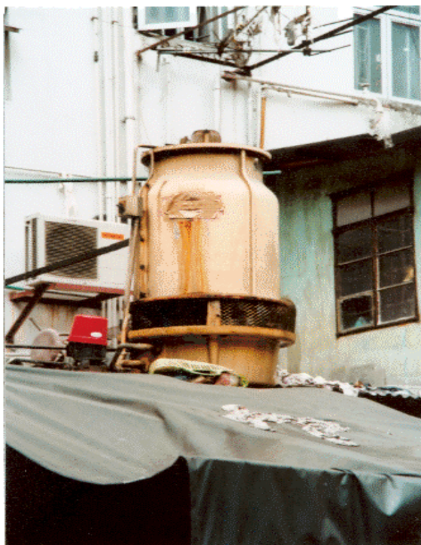
照片二 一堆破舊的冷卻塔 設置在油麻地附近樓宇的窗戶旁 (參閱第 6.28 段)
