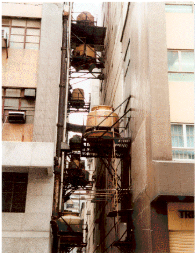
照片五 發現冷卻塔設在觀塘 兩幢工業大廈之間的後巷裏 (參閱第 6.28 段)
