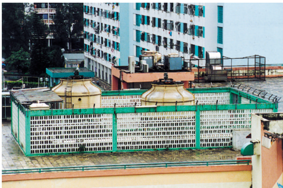
照片四 兩座巨大的冷卻塔設置在沙田一公共屋邨的平台上 (參閱第 6.28 段)
