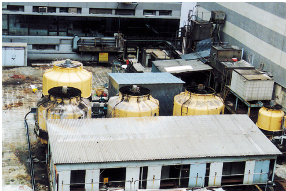
照片三 新舊冷卻塔設置在旺角一幢商業大廈的平台上 (參閱第 6.28 段)
