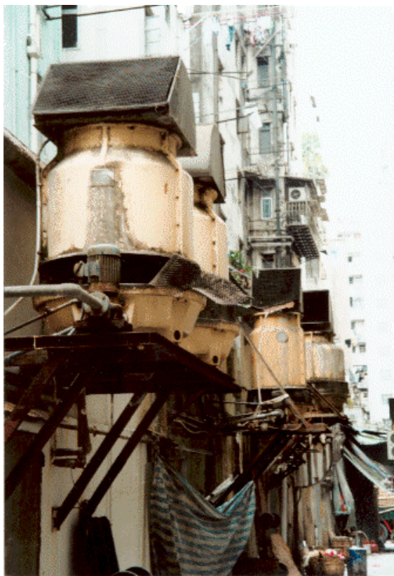
照片一 一堆破舊的冷卻塔 設置在旺角一條後巷裏 (參閱第 6.28 段)
