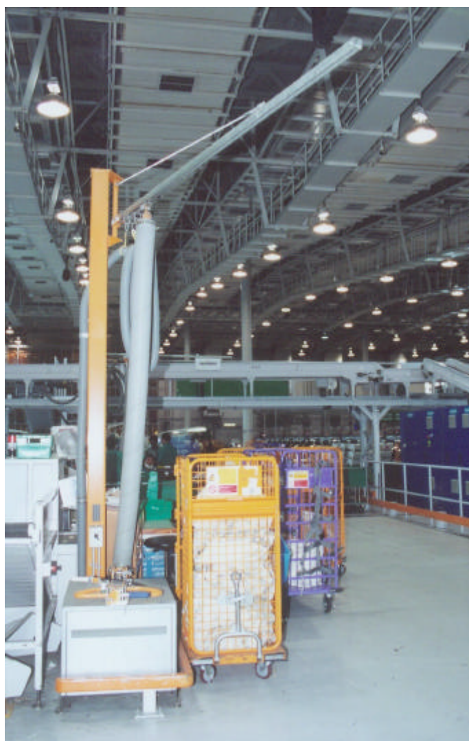
真空提升設備
