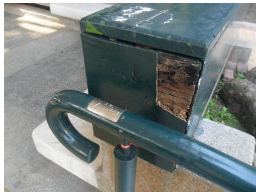
損壞的固定裝置
