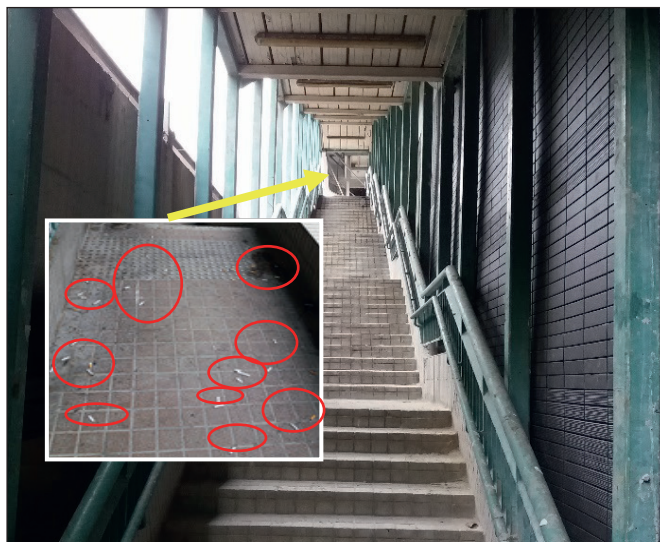
發現有煙頭的圍封式樓梯
