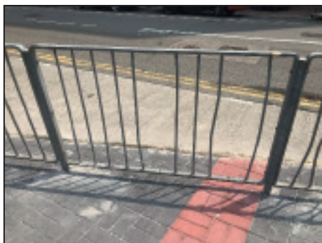
(c) 海濱道的欄杆破損
