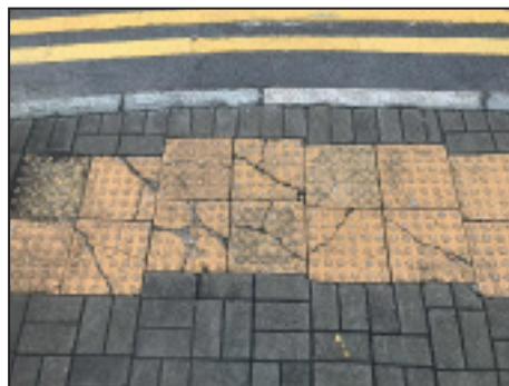
(b) 海濱道的凹凸紋地磚破損
