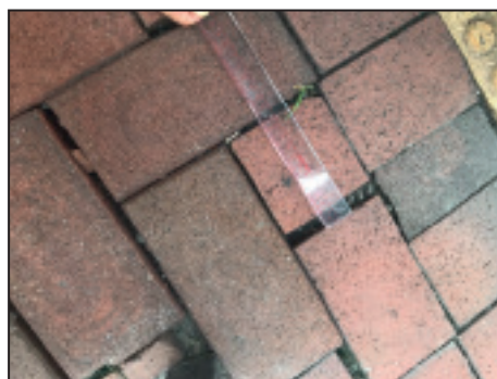
(f) 炮台街的鋪路磚之間縫隙闊逾 10 毫米
