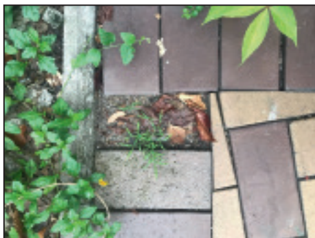
(a) 佐敦道的鋪路磚缺漏
