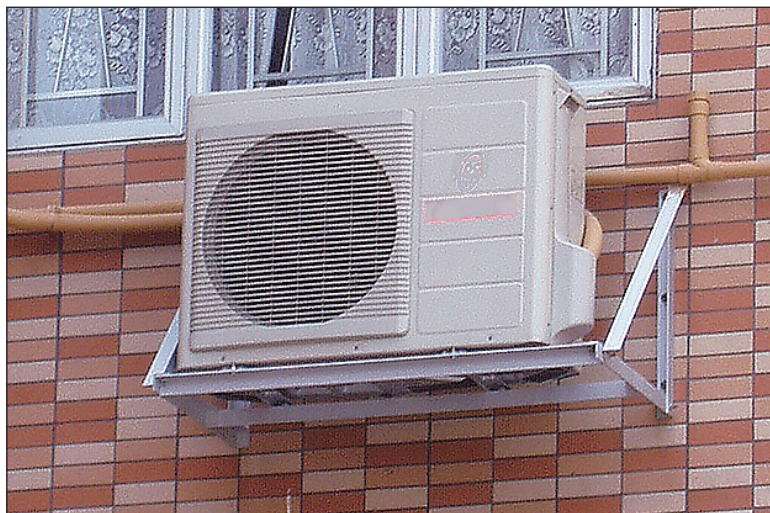
支承空調機的支架
