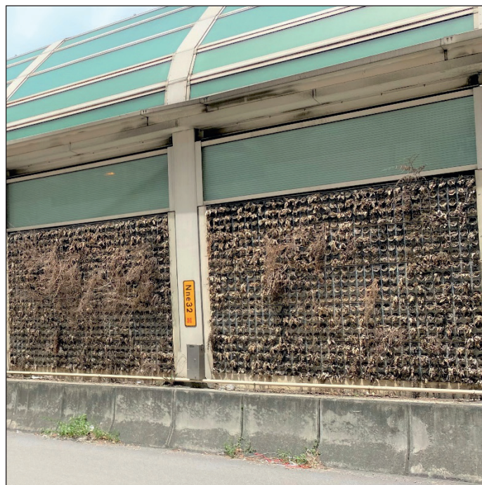
屯門公路市中心段垂直綠化板的枯萎植物 (2020 年 6 月)
