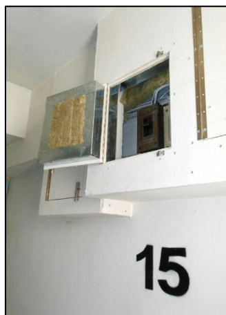
(b) 電纜和氣槽的保護
