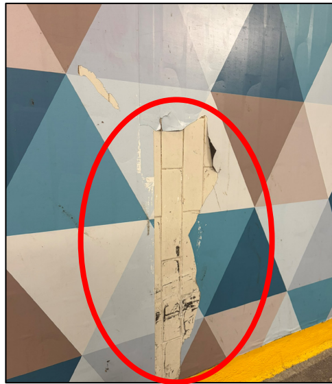
(b) 牆貼脫落
