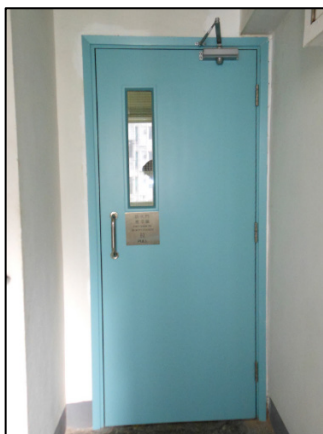
(a) Fire door
