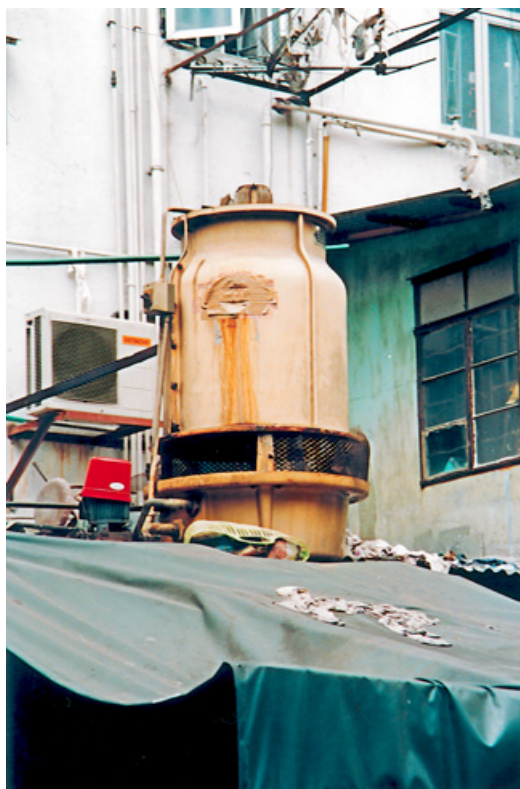
照片二 一堆破旧的冷却塔 设置在油麻地附近楼宇的窗户旁 (参阅第 6.28 段)
