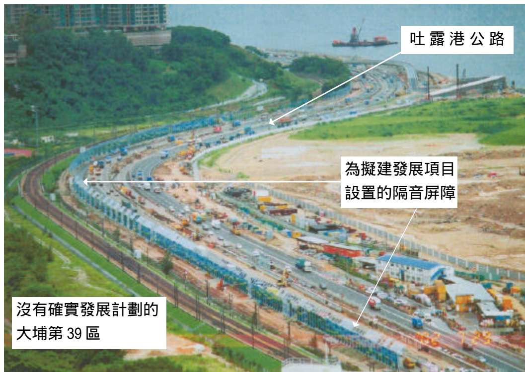
在吐露港公路擴闊工程下所設置的隔音屏障
